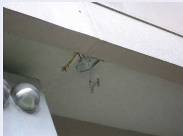
外壁の剥がれ
