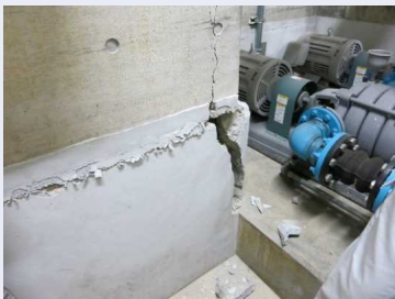
建物内部の亀裂
