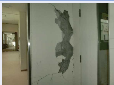
柱のひび割れ
