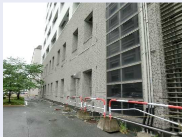
建物外壁タイルの崩落
