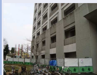
外壁タイル崩落の可能性が ある部分は立入禁止措置
