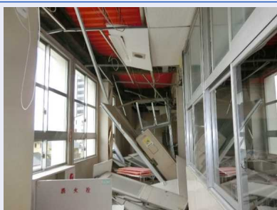
附属小学校廊下の天井崩落
