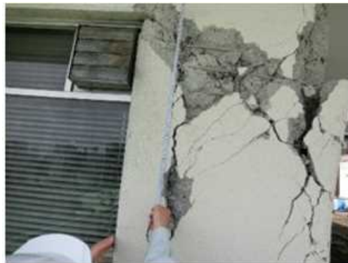
外来臨床研究棟 柱ひびわれ
