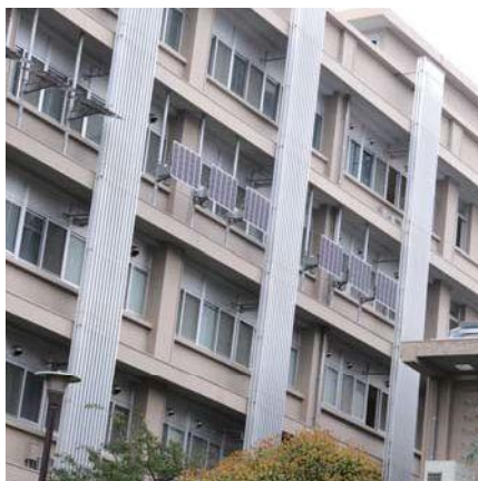
工学部1号館に取り付けられたソーラーシエルフ
