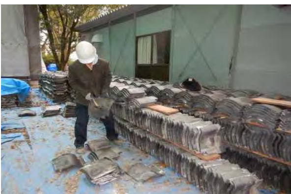
屋根棧瓦材 打音検査作業 (打撃音の違いによって破損の程度を判断)
