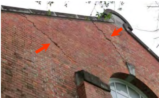
外壁(妻側)ひび割れ・ずれ
