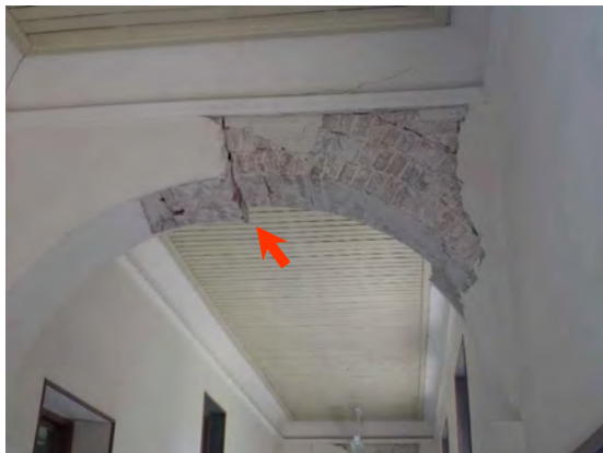
アーチ梁割裂・ずれ（2階）
