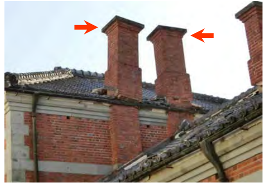
煙突傾斜・ずれ
