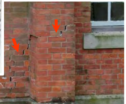
外壁・柱ひび割れ・ずれ(桁行方向)
