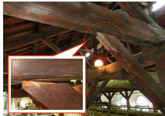
内部小屋組の斜材(方杖)はずれ
