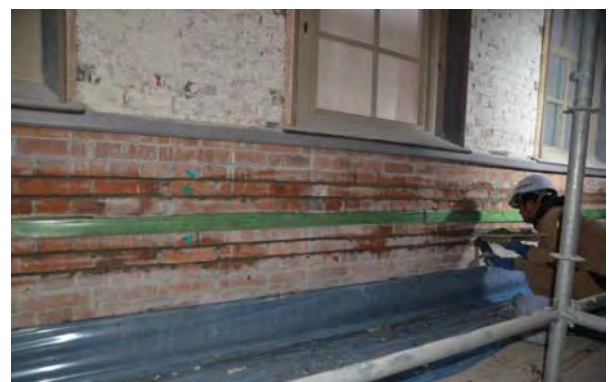
アラミド目地補強 ※煉瓦壁の水平方向の補強 (煉瓦の目地部分にアラミドロッドを挿入)
