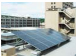
工学部研究棟Ⅳ 5kW
