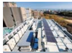
国際先端科学技術研究拠点施設 5kW
