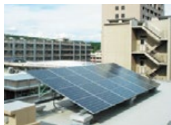
工学部研究棟Ⅳ 5kW
