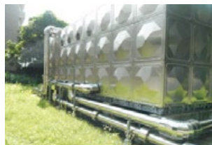
◀ 左/ろ過装置(井水をろ過しています) 右/受水槽(井水を貯めています)
