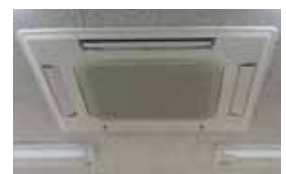
空調機取替後
