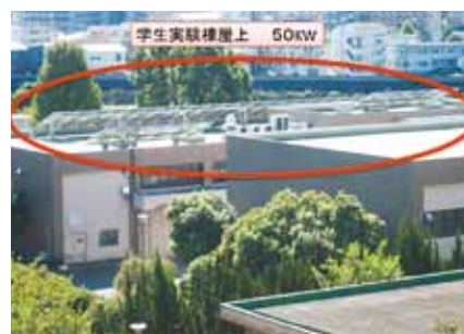
研究実験棟屋上 50kW
