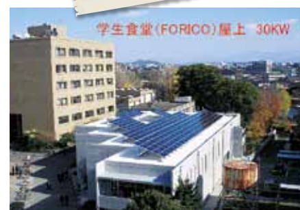
学生食堂(FORICO)屋上 30kW
