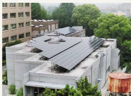
学生食堂(FORICO)屋上 30kW
