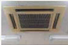
空調機取替前
