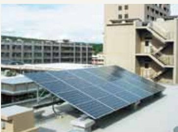
工学部研究棟Ⅳ 5kW
