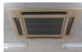
空調機取替前
